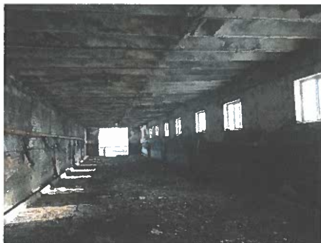
Fot. Nr 16-17. Stan pomieszczenia i stolarki drzwiowej.
