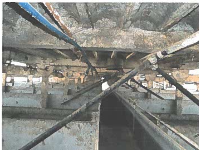
Fot. Nr 8-9. Stan pomieszczeń chlewni.
