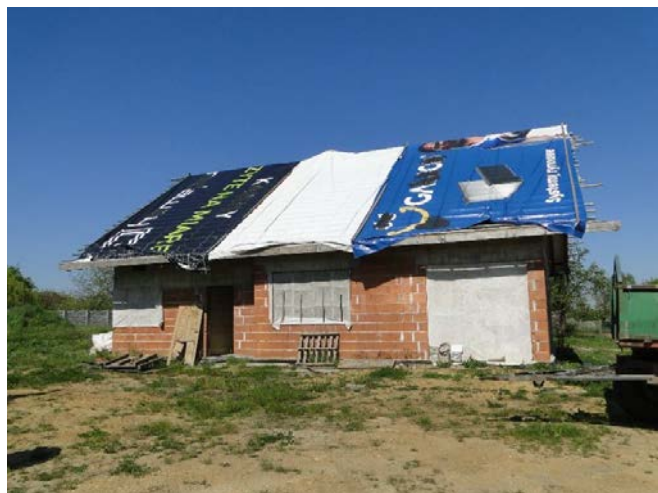
Fot. Nr 6-7. Bud. mieszkalny w trakcie budowy w południowej części działki nr 20.
